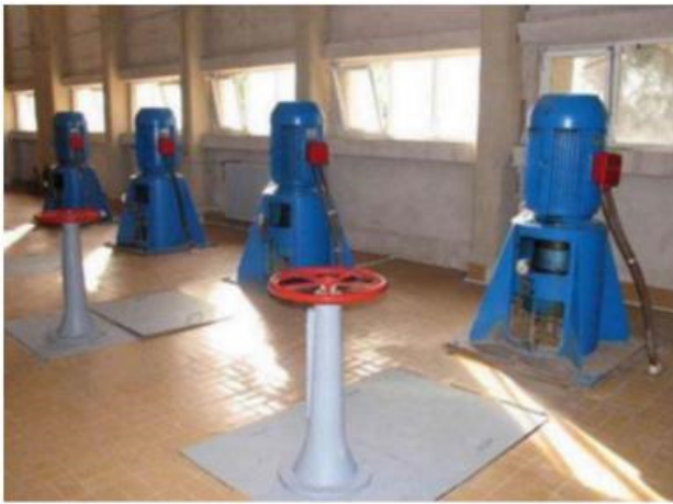
ПС сирове воде
